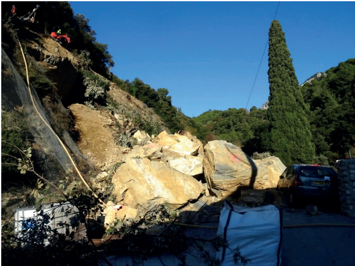
Figure 16 : Écroulement d'un talus anthropique constitué de calcaires à gros bancs avec interlits marneux du Crétacé supérieur - Mécanisme de glissement plan combiné avec des mécanismes de basculement (Menton / Photographie T. Bourdin)
