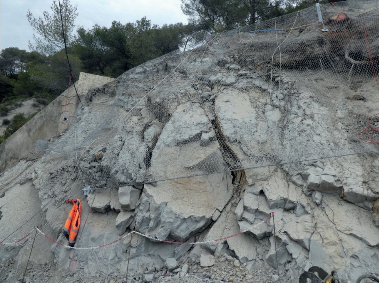
Figure 18: Mécanisme de type glissement plan au niveau de bancs de calcaires marneux à cassure conchoïdale de l'Eocène - Noter la courbure de la discontinuité de droite (Photographie T. Bourdin)
