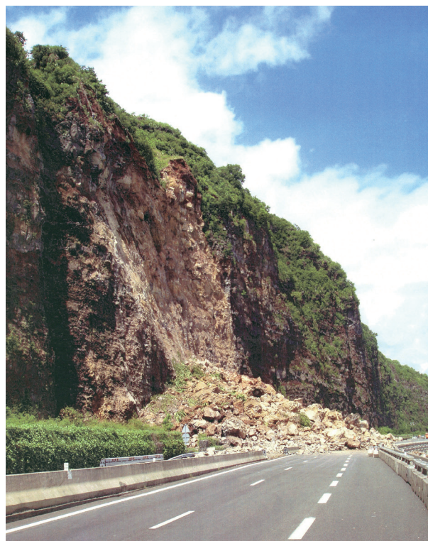
Figure 21: Éboulement d'une écaille sur la RN1 (photographie de J.L. Durville)
