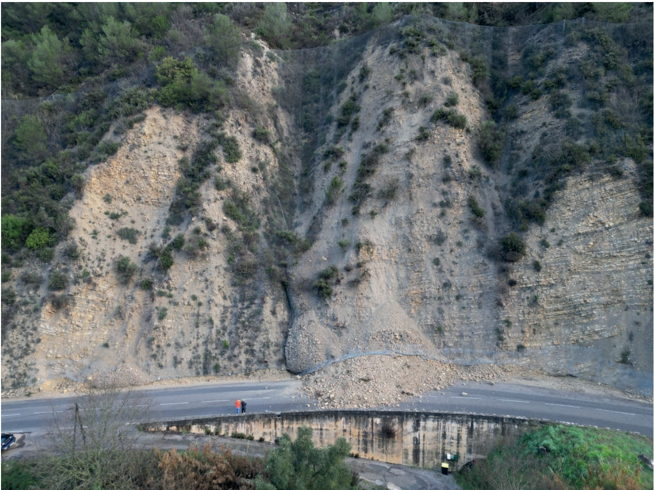
Figure 15 : Déstabilisation superficielle dans un talus partiellement anthropique constitué de calcaires marneux bien lités du Crétacé Supérieur (La Trinité / Photographie T. Bourdin)
