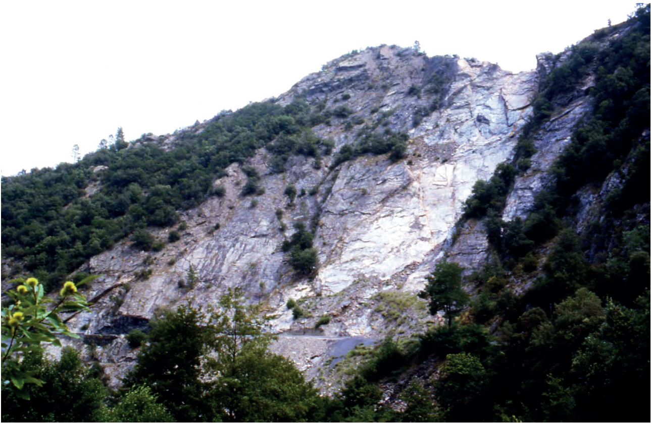
Figure 26 : Surface de rupture plane récente de grande extension (surface brillante) dans des schistes des Cévennes (Photographie R. Cojean)
