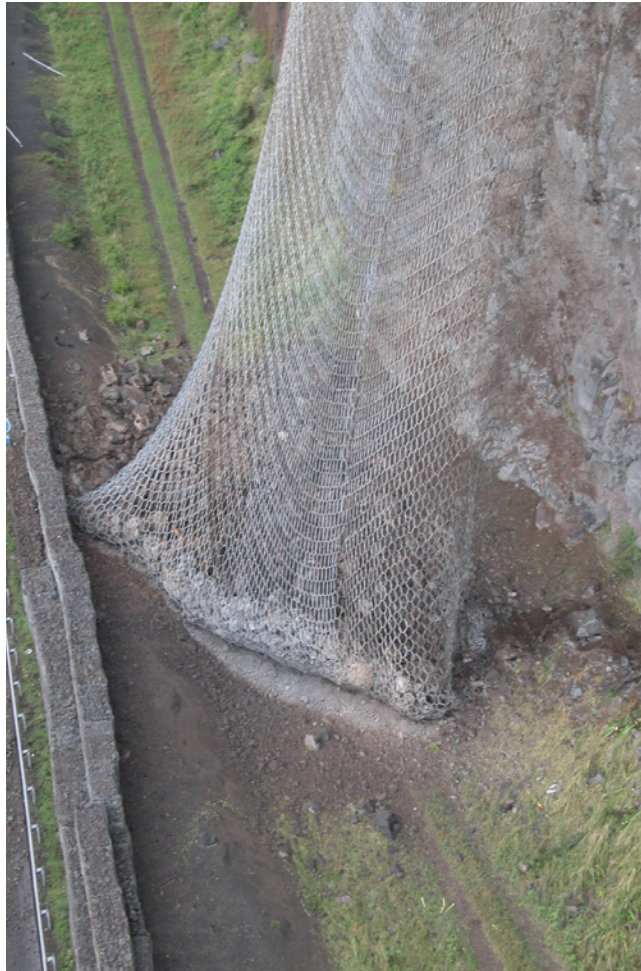
Figure 32 : Eboulement exceptionnel (Source : AVAROC)
