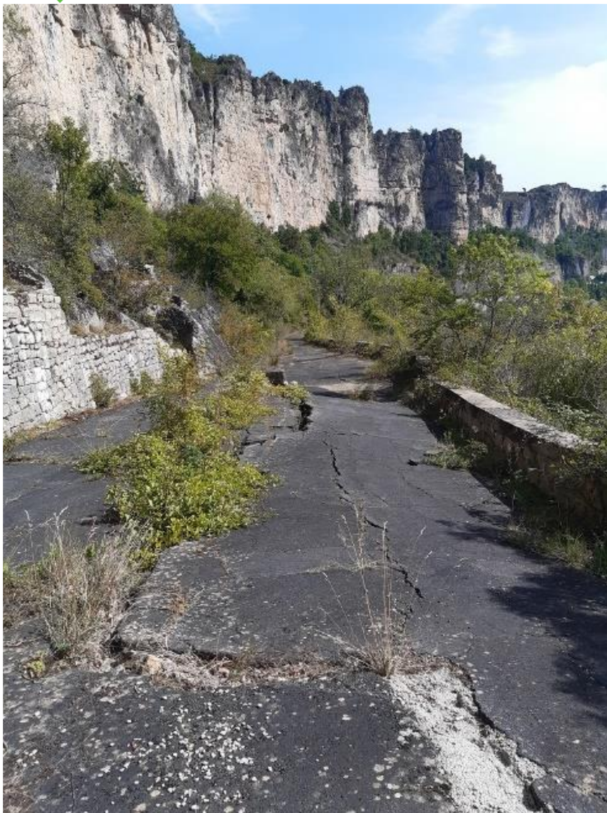
Figure 1 : vue de l'ancienne RN9 au Pas de l'Escalette, témoin privilégiée de 20 ans de déformation du versant
