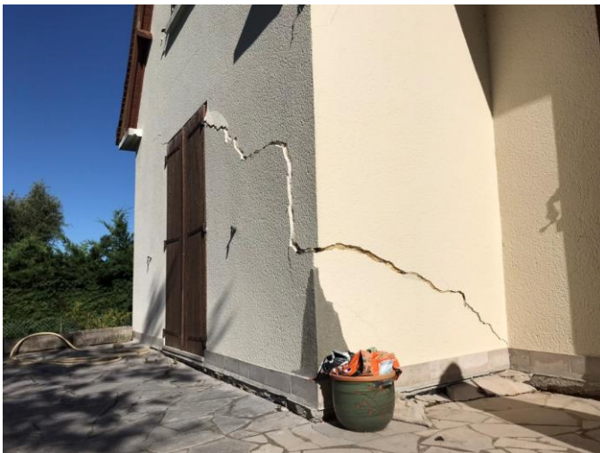
Fissure produite par retrait-gonflement d'argiles en fondation © L.I.A., Cerema 2022
