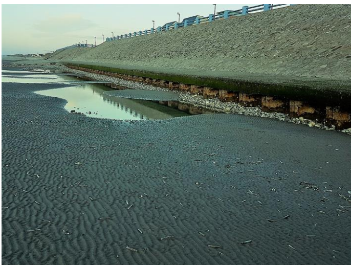
Pied du perré désensablé de Quend-plage © O.B. 2020
